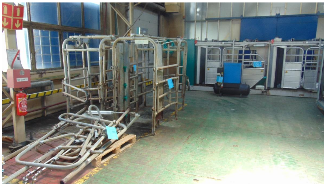
1. Automat udojowy z systemem bramek selekcyjnych i kompresorem – widok ogólny.
